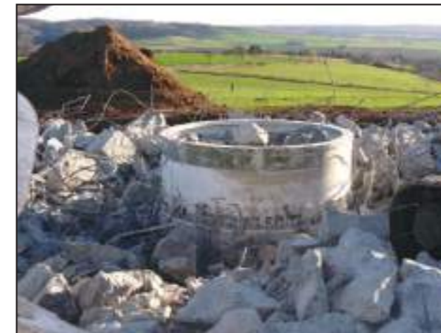
Figure 57 : Base de l'éolienne
