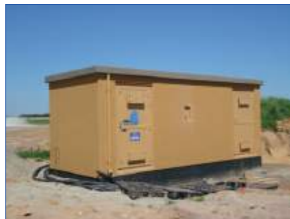
Figure 584 : Exemple d'un poste électrique de livraison
