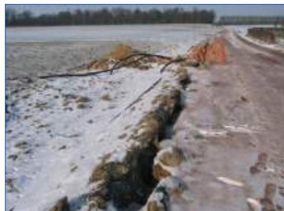
Figure 383 : Réalisation d'une tranchée à câbles souterrains sur le site du parc de Sachin
