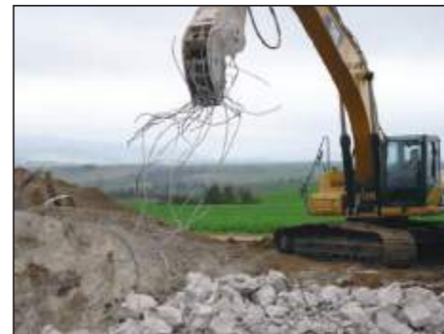
Figure 58 : Destruction de la base
